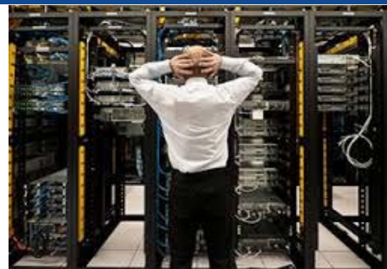
机房及数据中心
